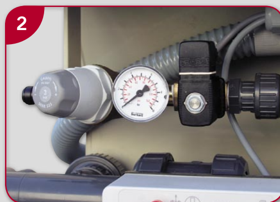
Druckminderer in der Frischwasserzuleitung
