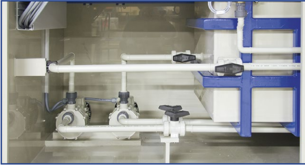
Pumpstation zur Befüllung und Entleerung
